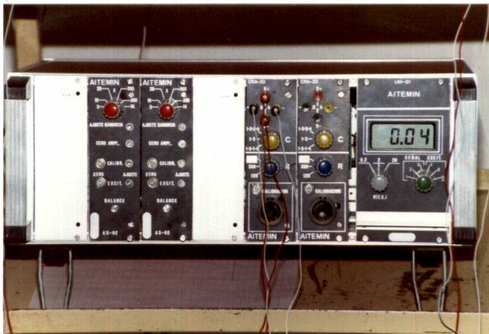
Foto N° 4 Detalle del equipo de medida.
